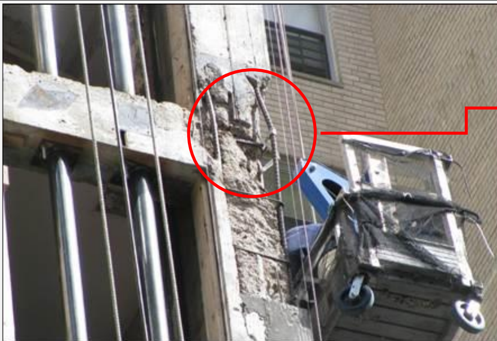
Pandeo de Refuerzo Vertical
